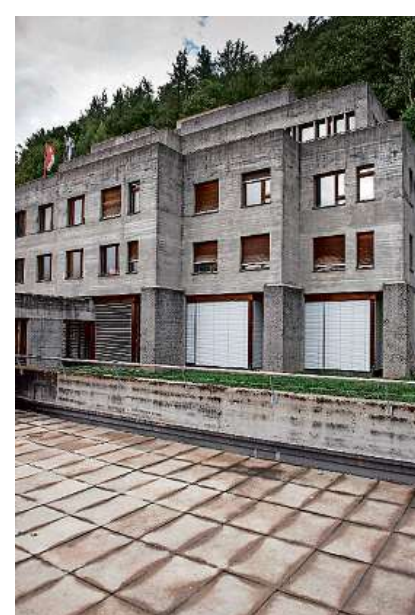
Gibt zu reden: Das Konvikt der Bündner Kantonsschule wird derzeit für rund 31 Millionen Franken saniert. Bild Olivia Item
